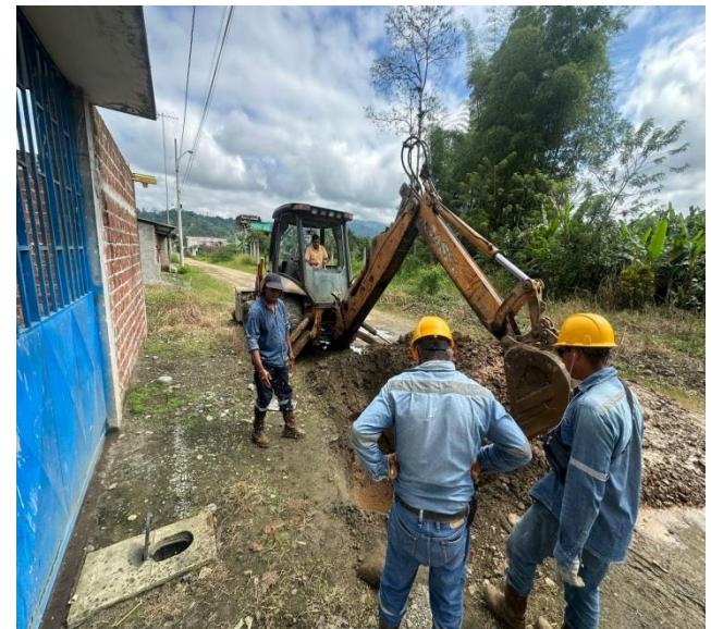
4 DICIEMBRE – 2023. EXCAVACION PARA ARREGLO DE FUGAS Y GUIAS DE ALCANTARILLADO SR. PUMA SAYAY EN CALLE FRANCISCO CHAVEZ
