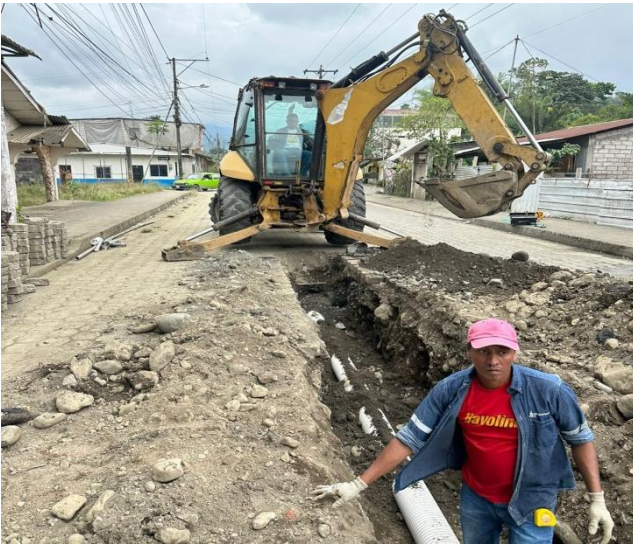
14 AGOSTO – 2023. EXCAVACION PARA DESTAPAR ALCANTARILLADO COLAPSADO Y CAMBIAR TUBERIA, CALLE; 4 DE DICIEMBRE Y MIGUEL ANDRADE
