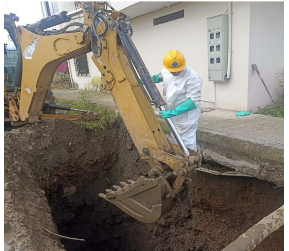
25 ABRIL – 2023. EXCAVACION PARA REPARAR ALCANTARILLADO SANITARIO COLAPSADO, EN EL BARRIO VICTOR CORRAL MANTILLA, CALLEJON PEATONAL
