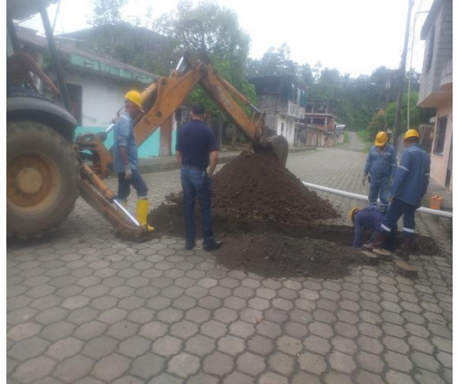
31 MAYO – 2023. EXCAVACION PARA REALIZAR 3 GUIAS DE ALCANTARILLADO SANITARIO, 1 GUIA DE AGUA POTABLE Y LIMPIEZA DE DESFOGUE DE ALCANTARILLADO EN EL BARRIO LA DOLOROSA.
