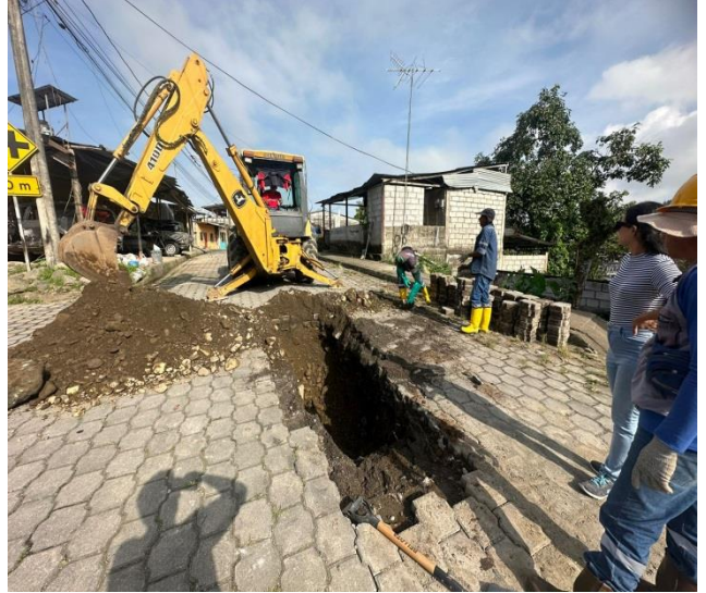
24 AGOSTO – 2023. EXCAVACION PARA DESTAPAR ALCANTARILLADO COLAPSADO Y CAMBIAR TUBERIA, CALLE SIMON BOLIVAR Y ELOY ALFARO
