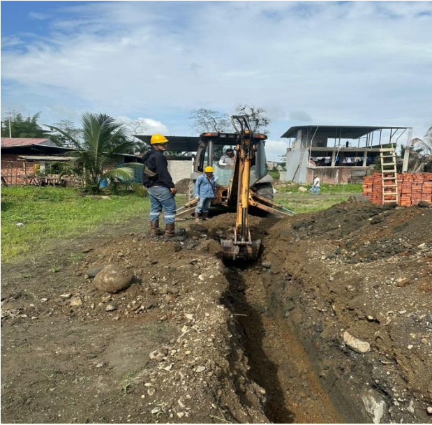
11 DICIEMBRE – 2023. EXCAVACION PARA INSTALACION DE GUIAS DE AGUA POTABLE, SRA. RAMON ALVAREZ VERONICA, EN CALLES P.V. MALDONADO Y ABDON CALDERON
