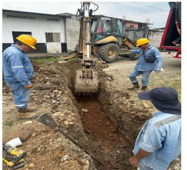
13 DICIEMBRE – 2023. EXCAVACION PARA ATENCION DE FUGA DE AGUA EN LA RED PRINCIPAL EN BARRIO BELLAVISTA Y LIMPIEZA DE CAJA DE ALCANTARILLADO
