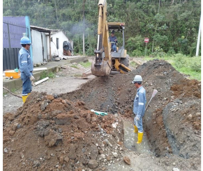
4 JULIO – 2023. EXCAVACION PARA REPARAR FUGA DE AGUA Y DESTAPAR ALCANTARILLADO COLAPSADO, CALLE; PEDRO VICENTE MALDONADO Y CELINDA MUÑOZ.
