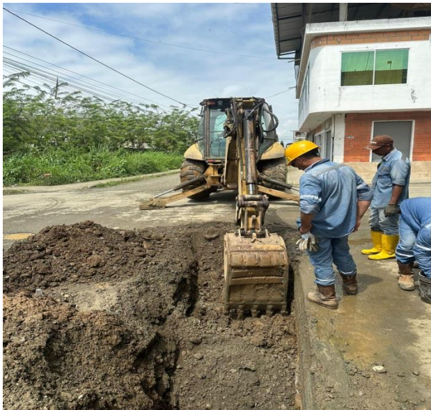
12 DICIEMBRE – 2023. EXCAVACION PARA INSTALACION DE GUIA DE AGUA POTABLE DEL SR. MARTINEZ RAMIREZ OLMEDO HIDALGO
