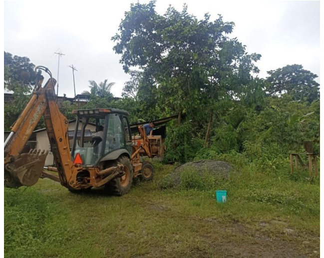
5 ABRIL – 2023. EXCAVACION PARA REALIZAR 3 GUIAS NUEVAS DE AGUA POTABLE, EN DIFERENTES PARTES DEL CANTON CUMANDA.
