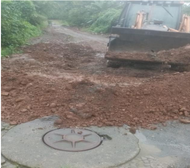
18 MAYO – 2023. EXCAVACION PARA REALIZAR 2 GUIAS DE ALCANTARILLADO SANITARIO, 1 GUIA DE AGUA POTABLE, RELLENO DE ZANJA EN CALLE; CARLOS ESPINOZA.
