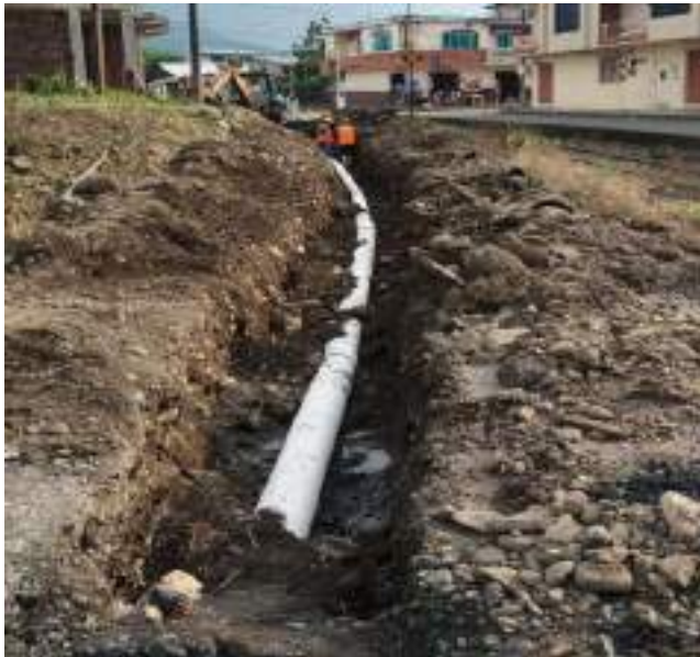
11 Abril – 2019. Excavación para reparar alcantarillado sanitario colapsado, en la calle Eloy Alfaro entre 9 de Octubre y Simón Bolívar.
