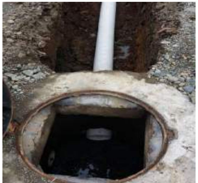
12 Abril – 2019. Excavación para extensión de red de alcantarillado sanitario en la calle: Riobamba entre Cesar Calvopiña y Perimetral.
