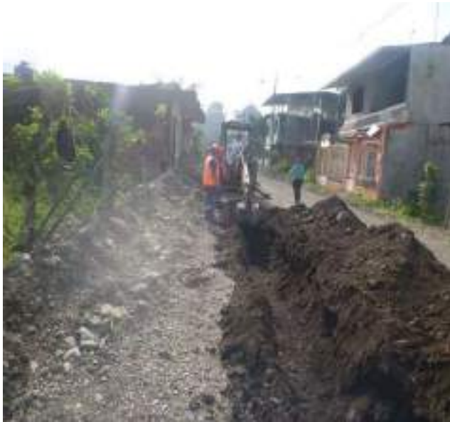
9 Abril – 2019. Excavación extensión de red principal de agua potable en la calle: Eloy Chicaiza entre Martin Ortega y Miguel Andrade.
