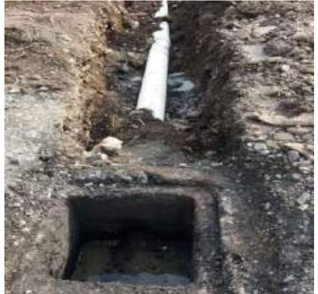
11 Abril – 2019. Excavación para reparar alcantarillado sanitario colapsado, en la calle Eloy Alfaro entre 9 de Octubre y Simón Bolívar.
