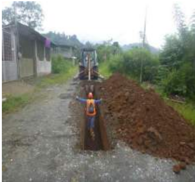
4 Abril – 2019. Excavación para extensión de red principal en la calle Transversal i, entre Simón Bolívar y Longitudinal 3.
