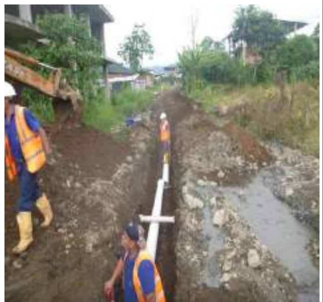
11 Febrero - 2019. Excavación para extensión de red de alcantarillado sanitario en la calle: Gómez Rendón entre Manuel Cahuana y Segundo Merino.
