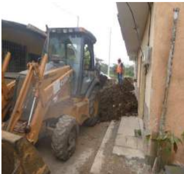
16 Septiembre – 2019. Excavación para cambio de tubería por colapso de alcantarillado sanitario, en la calle; Pasaje 2 entre P. Constituyente y Abdón Calderón.
