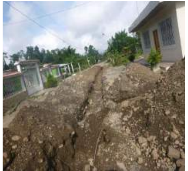
9 Abril – 2019. Excavación extensión de red principal de agua potable en la calle: Eloy Chicaiza entre Martin Ortega y Miguel Andrade.
