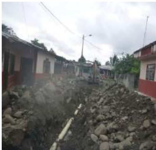
25 de Junio- 2019. Excavación en alcantarillado colapsado, se realiza un cambio de Red Principal
