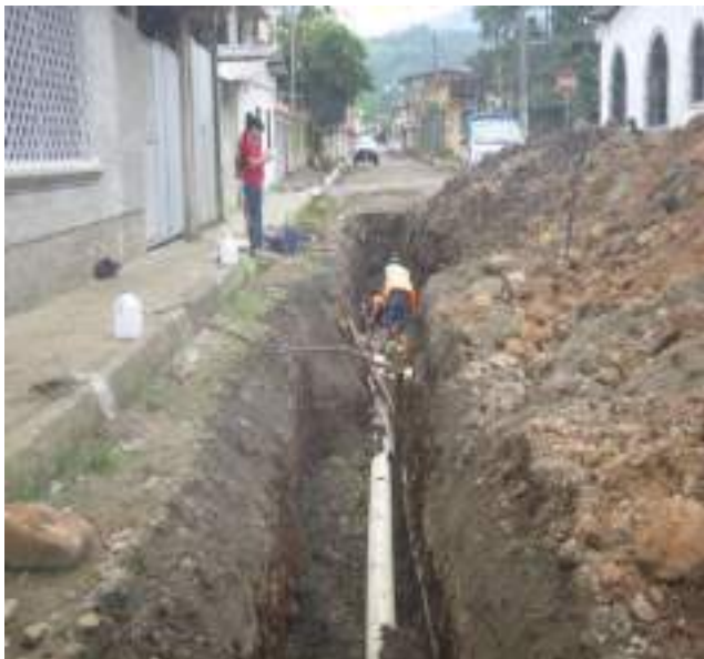
19 Marzo – 2019. Excavación para cambio de tubería de alcantarillado sanitario en la Calle: 24 de Mayo y Celinda Muñoz.
