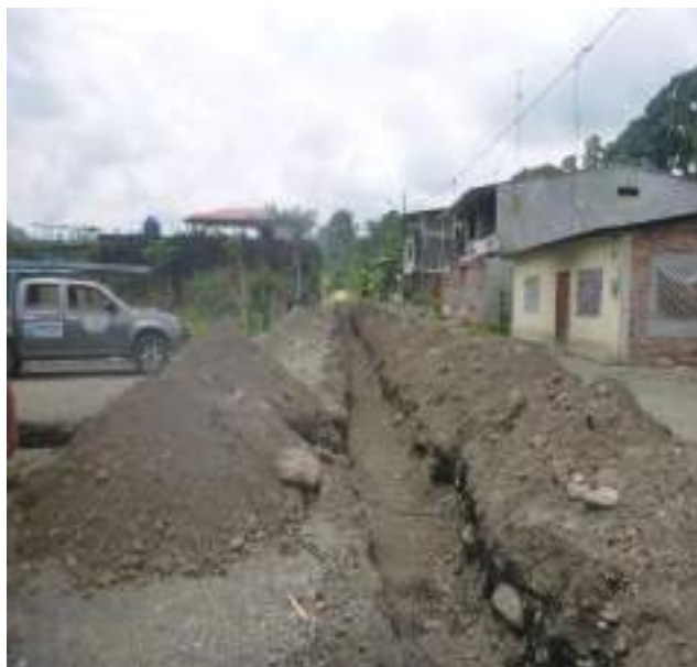
9 Abril – 2019. Excavación extensión de red principal de agua potable en la calle: Eloy Chicaiza entre Martin Ortega y Miguel Andrade.
