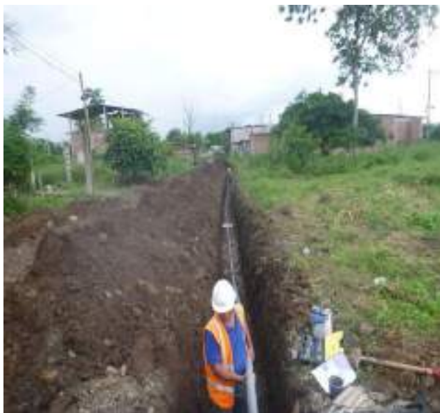
13 Febrero - 2019. Excavación para extensión de red de agua potable en la calle: Gómez Rendón entre Manuel Cahuana y Segundo Merino.
