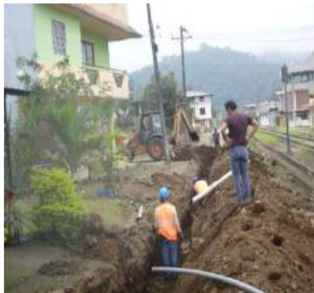
19 Septiembre – 2019. Excavación para reubicar red de agua potable y acometidas, en la calle; Eloy Alfaro entre Jaime Cabrera y Ricardo Espinoza.
