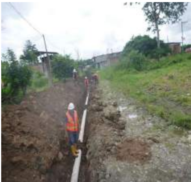
11 Febrero - 2019. Excavación para extensión de red de alcantarillado sanitario en la calle: Gómez Rendón entre Manuel Cahuana y Segundo Merino.
