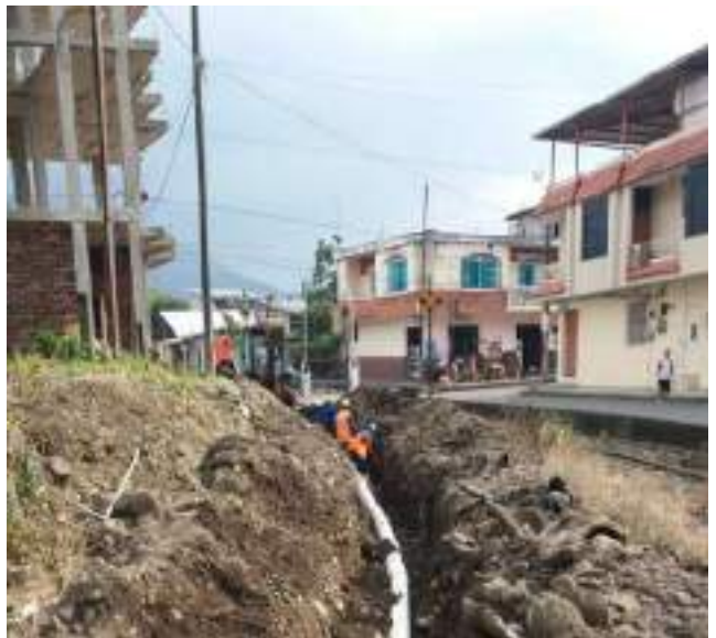
11 Abril – 2019. Excavación para reparar alcantarillado sanitario colapsado, en la calle Eloy Alfaro entre 9 de Octubre y Simón Bolívar.
