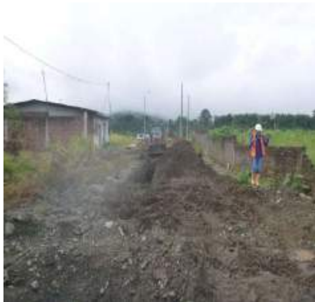
13 Febrero – 2019. Relleno de zanja por extensión de red de agua potable en la calle: Segundo Merino, entre Gómez Rendón y 10 de Agosto.
