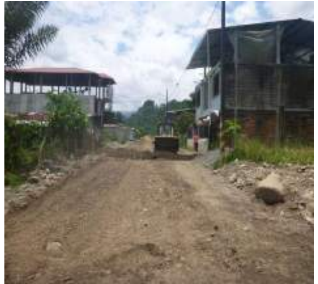
10 Abril – 2019. Excavación extensión de red principal de agua potable en la calle: Eloy Chicaiza entre Martin Ortega y Miguel Andrade.
