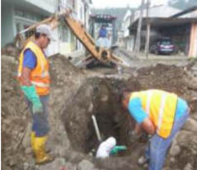
Diciembre 14 - 2018. Excavación para reparación de alcantarillado colapsado en la calle. Juan León Mera y Atahualpa.
