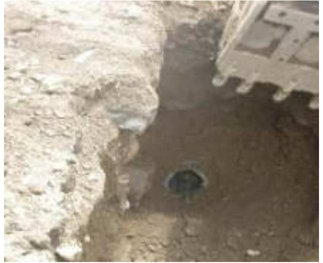
Septiembre 13 - 2018. Excavación para destapar alcantarillado colapsado, en la Calle: P.V. Maldonado y Simón Bolívar.
