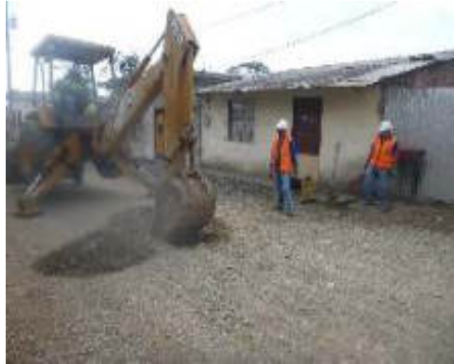
Agosto 30 - 2018. Excavación para destapar alcantarillado colapsado, en la Calle: 10 de Agosto y Baltazar Curillo.
