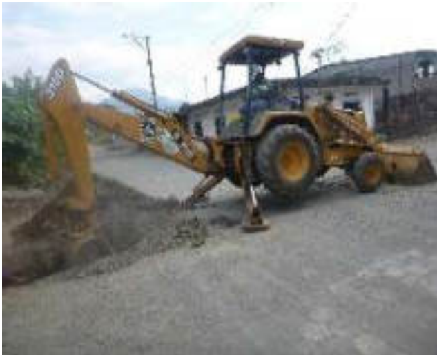
Agosto 30 - 2018. Excavación para destapar alcantarillado colapsado, en la Calle: Gómez Rendón y Baltazar Curillo.
