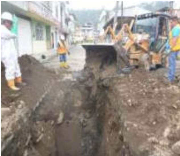
Diciembre 14 - 2018. Excavación para reparación de alcantarillado colapsado en la calle. Juan León Mera y Atahualpa.
