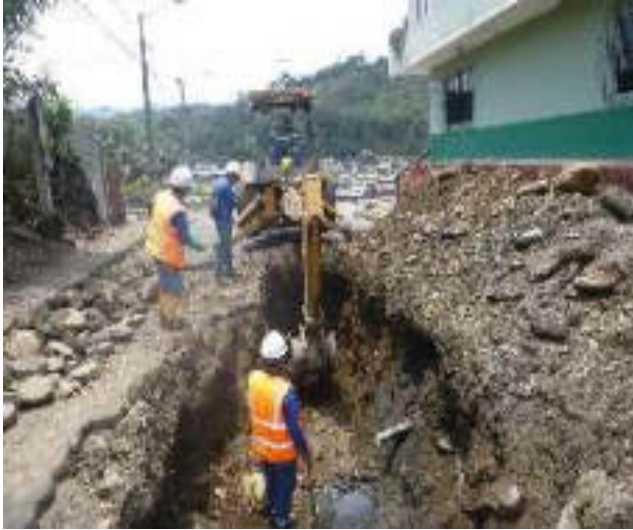
Septiembre 13 - 2018. Excavación para destapar alcantarillado colapsado, en la Calle: P.V. Maldonado y Simón Bolívar.
