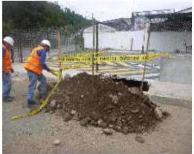
Agosto 23 - 2018. Excavación para guía nueva de alcantarillado sanitario, en la Calle: P. V. Maldonado y Cristóbal Colon.
