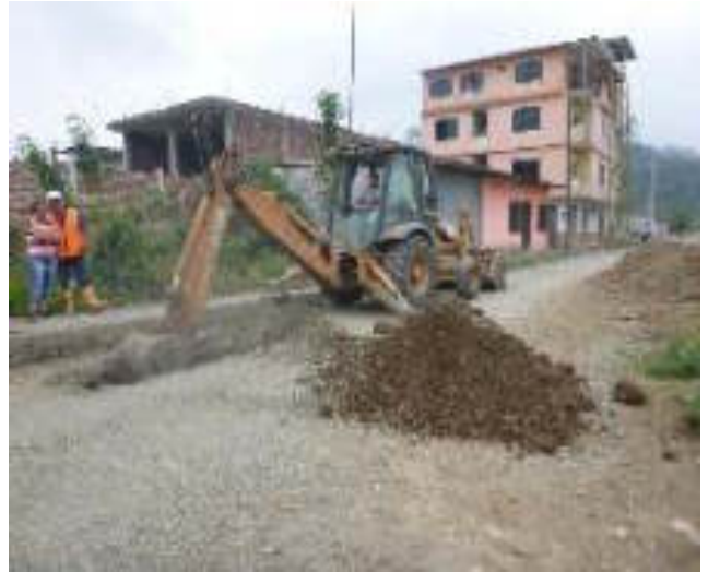
Octubre 29 - 2018. Excavación para destapar alcantarillado colapsado, en la Calle: Francisco Chávez y 5 de Junio.
