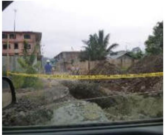
Octubre 29 - 2018. Excavación para destapar alcantarillado colapsado, en la Calle: Francisco Chávez y 5 de Junio.
