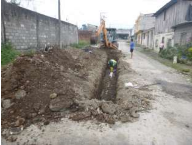
Octubre - 2017. Excavación para cambio de tubería colapsada en la calle: Jaime Cabrera entre Cumandá y Rumiñahui.
