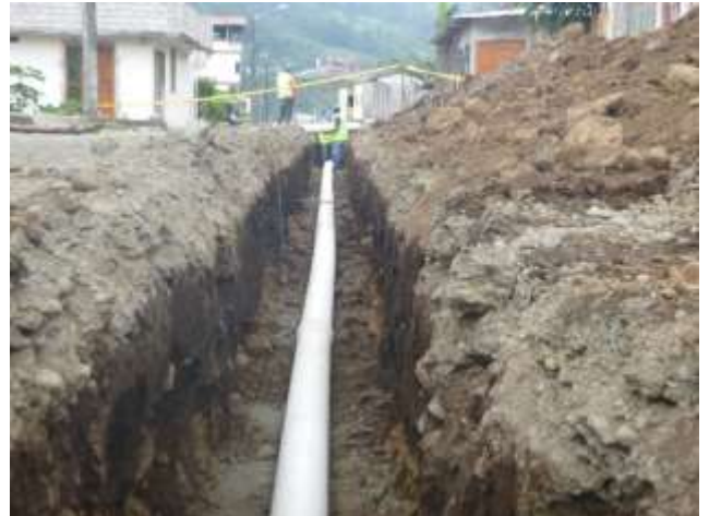
Julio - 2017. Colocación de tubería de Alcantarillado sanitario (200mm). Calle: Eugenio Espejo entre 10 de Agosto y Jaime Cabrera
