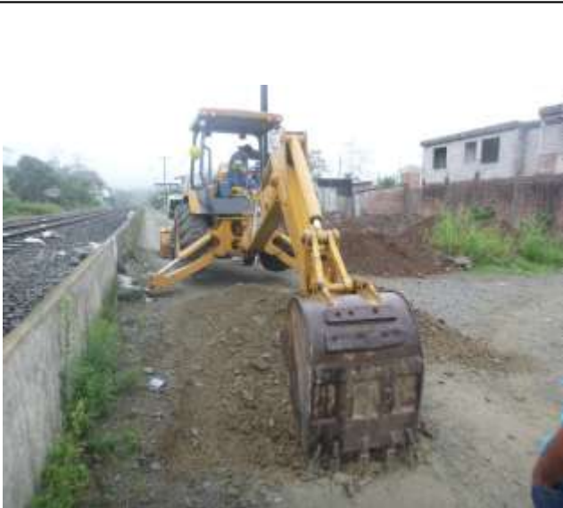
Diciembre - 2017. Excavación para instalación de tubería pvc 220mm de alcantarillado sanitario colapsado, en la calle: Eloy Alfaro y Celinda Muñoz
