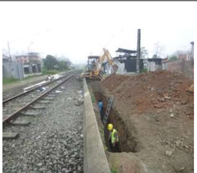
Diciembre - 2017. Excavación para instalación de tubería pvc 220mm de alcantarillado sanitario colapsado, en la calle: Eloy Alfaro y Celinda Muñoz
