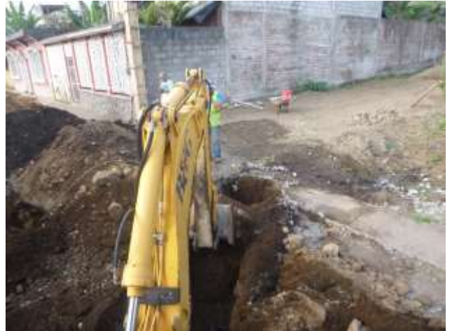
Julio - 2017. Excavación para instalación de acometidas domiciliarias de alcantarillado sanitario. Calle: Eugenio Espejo entre 10 de Agosto y Jaime Cabrera
