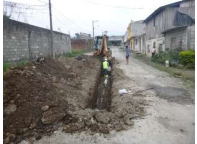
Octubre - 2017. Excavación para cambio de tubería colapsada en la calle: Jaime Cabrera entre Cumandá y Rumiñahui.
