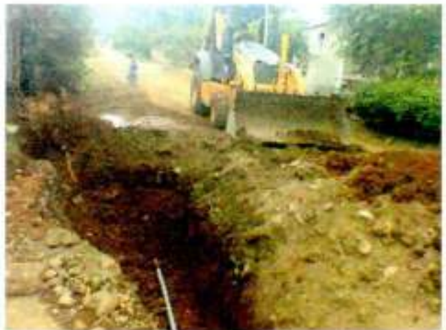
Junio-2016 Relleno de zanja por instalación de tubería de agua red principal calle: G. Suarez entre Perimetral y Cesar Calvopiña
