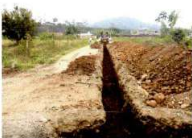
24-Octubre-2016 Excavación Alcantarillado nuevo red principal calle: Transversal I entre Simón Bolívar y 10 de Agosto
