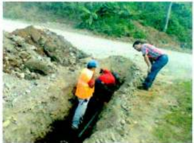
Junio-2016 Excavación para red de agua potable red principal calle: G. Suarez entre Perimetral y Cesar Calvopiña
