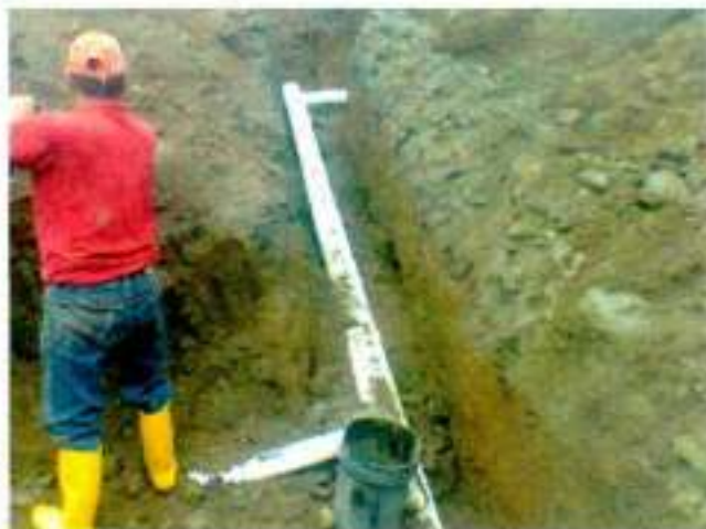
Junio-2016 Tendido de tubería de alcantarillado sanitario calle: G. Suarez entre Perimetral y Cesar Calvopiña
