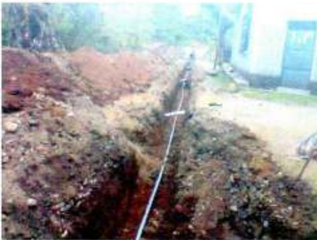
Junio-2016 Tendido de tubería de agua potable red principal calle: G. Suarez entre Perimetral y Cesar Calvopiña
